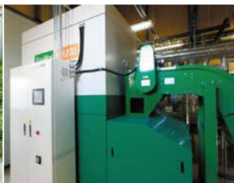
木質チップボイラー
