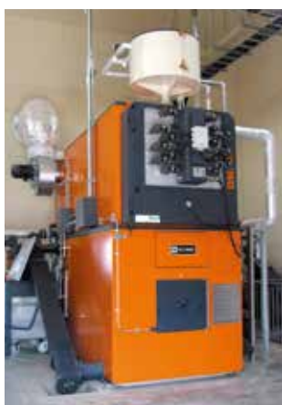
木質チップボイラー
