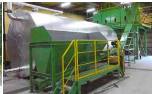
木質バイオマスボイラー
