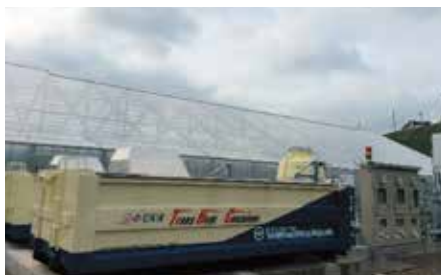
廃棄物処理施設から発生する廃熱を蓄熱コンテナで温室に供給
