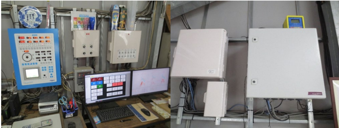
図9 ハウス入口の作業室に設置された既設ハウスおよび新設ハウスの統合環境制御装置
