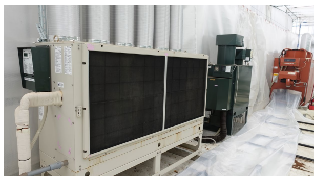
図 2 高軒高ハウスの暖房設備
