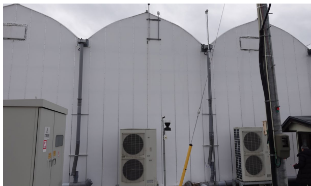
図 4 高軒高ハウスの前室とヒートポンプ室外機 (令和 6 年 1 月 31 日撮影)
