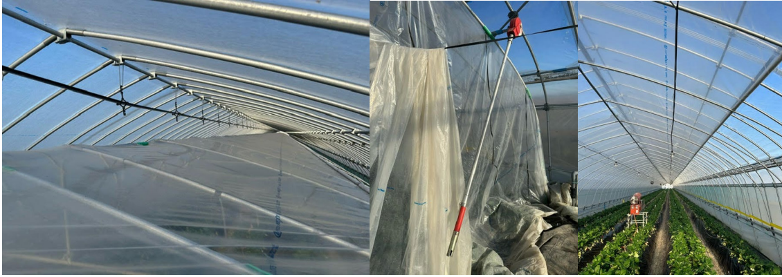
図3 ウォーターカーテン設備
