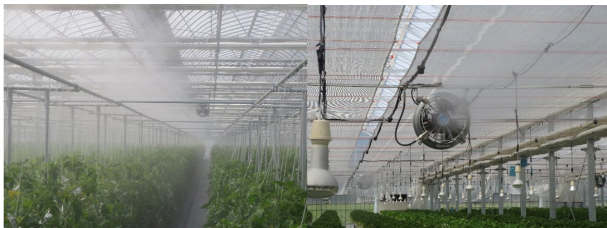
図8 細霧冷房装置による細霧噴霧中の様子
