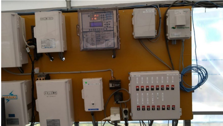
図5 盤・計測制御機器類（上段中：日射比例給液制御装置、上段右：環境・光合成モニタリング装置（Thinking Farm）、下段右：UECS 環境制御装置）
