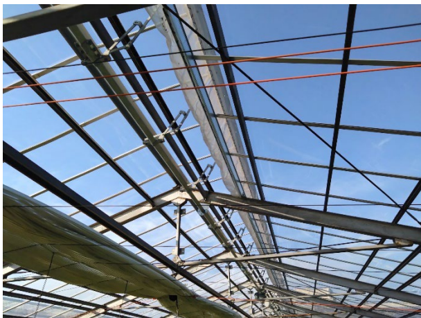
図7 追加施工した天窓枠と自動開閉装置。ハウス骨材、外張被覆資材は既設のもの。
