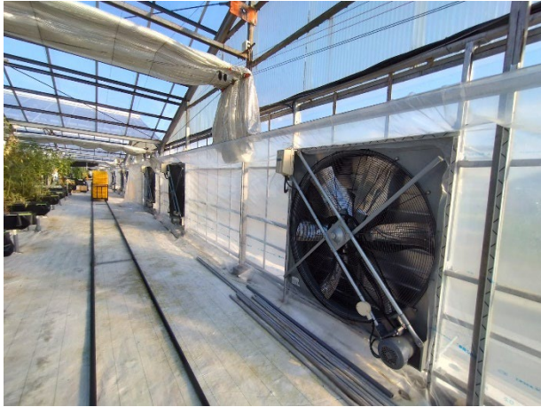
図8 吹き出し式の大型換気扇。1間口（10m）に2台、全20台を設置。
