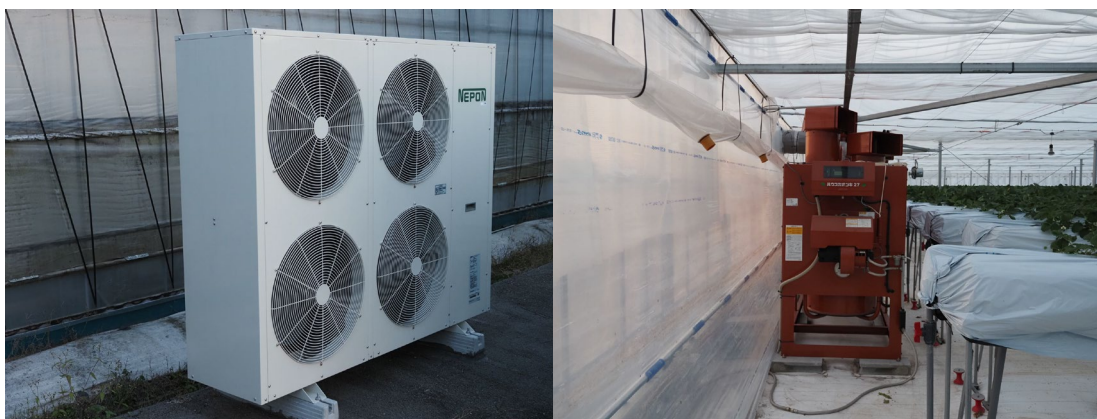
ヒートポンプ室外機
