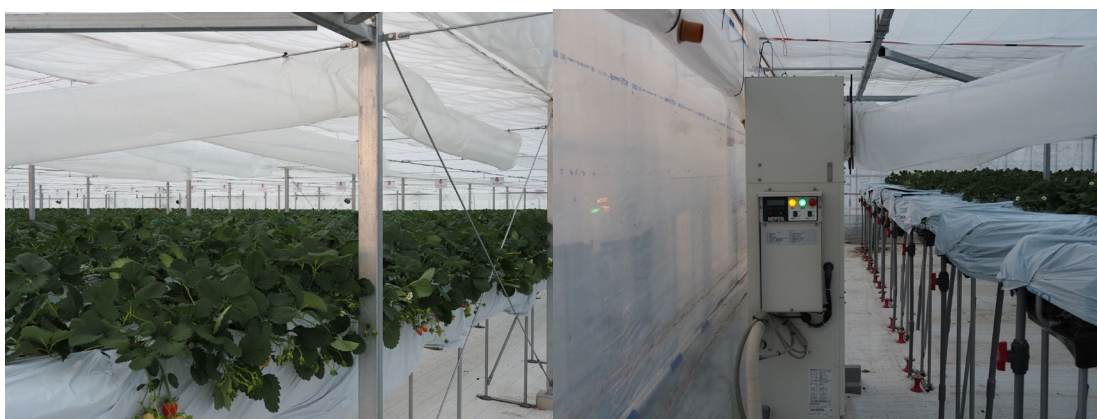
イチゴ高設栽培とカーテン下の送風ダクト 送風ダクトを接続したヒートポンプ室内機
