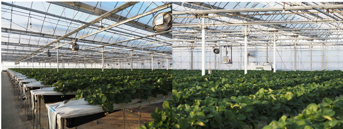
図5 ハウスのトラス構造と高設栽培ベンチおよび循環扇（左）、温風暖房機（右奥）
