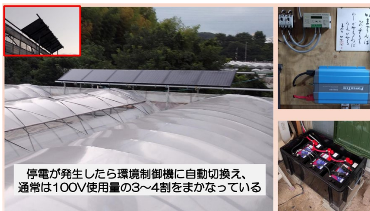
図 12 太陽光発電装置とバッテリーによる停電対策
