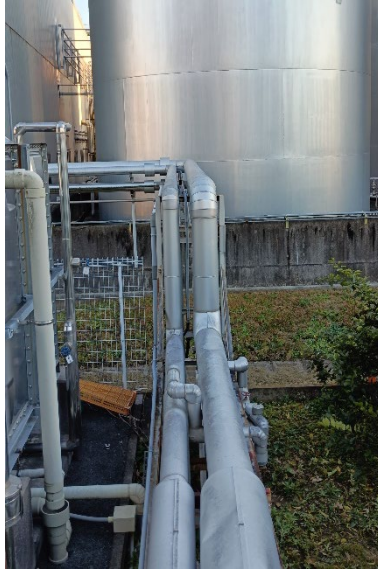
排熱用パイプ 隣接された辻製油からうれし野アグリへ 出所：植物工場研究会撮影
