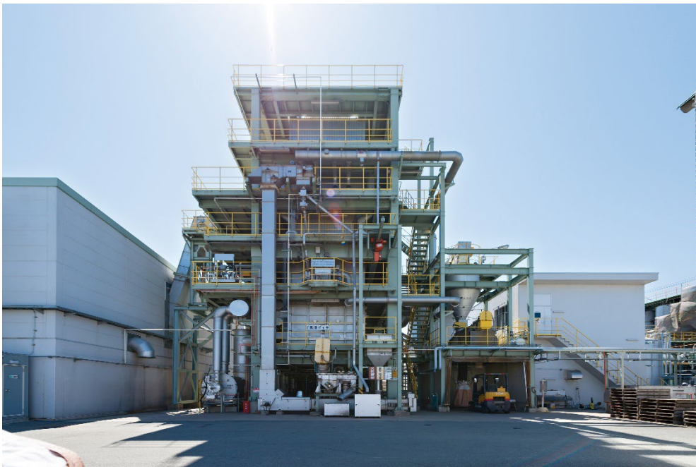
バイオマスボイラー外観 出所：うれし野アグリ提供
