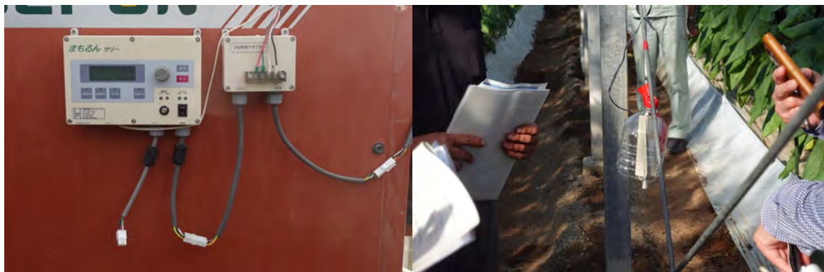
図4 病害防除用途の暖房機制御装置「まもるん サリー」(左)と 同装置の結露センサー(右)
