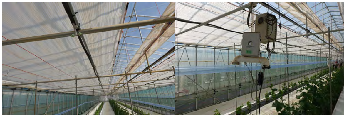
図3 単棟パイプの遮光カーテンとミスト装置(左)と試験用の環境モニタリング用センサー類(右)
