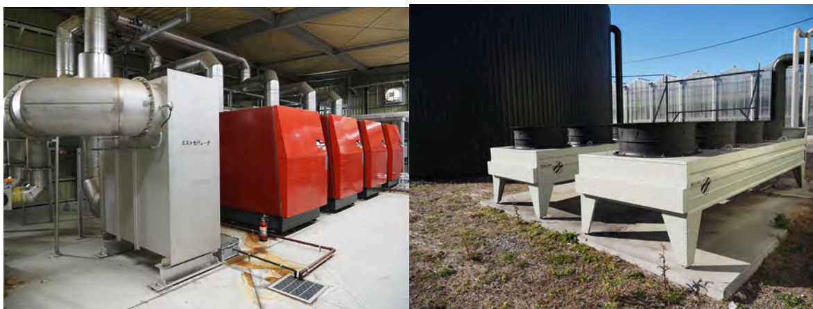
図3 潜熱回収型温湯ボイラーとCO 2 排気ダクト(左)とCO 2 徐熱用ドライクーラー(右)
