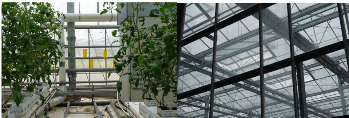
図2 トマト栽培区画のヒートポンプ送風ダクト設置状況(左)、 パプリカ栽培区画の天窓(右、防虫ネット除去後の状況)
