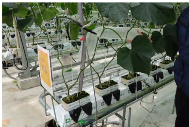
図6 養液栽培区の上下の送風ダクト
