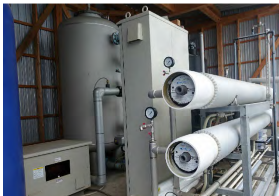
図2 RO膜原水処理装置
