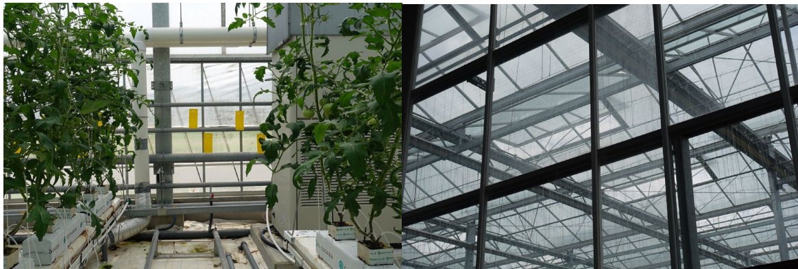
図2 トマト栽培区画のヒートポンプ送風ダクト設置状況(左)、 パプリカ栽培区画の天窓(右、防虫ネット除去後の状況)
