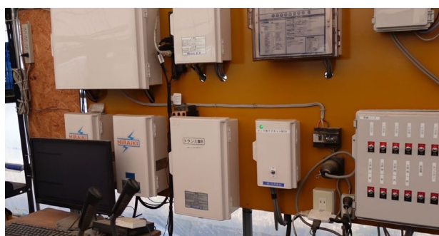
図4 操作盤を内蔵した環境制御装置(右下)
