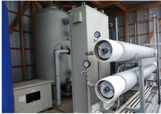
図2 RO膜原水処理装置
